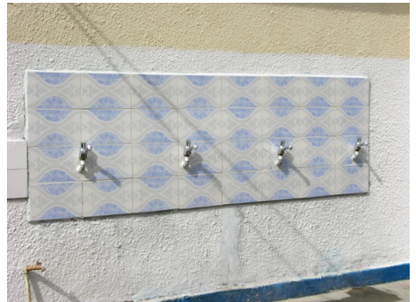
Aus diesen 4 Wasserhähnen kann Trinkwasser entnommen werden
